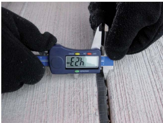
Bild 5: Fugenflankenabriss durch übergroße Fugendehnung
