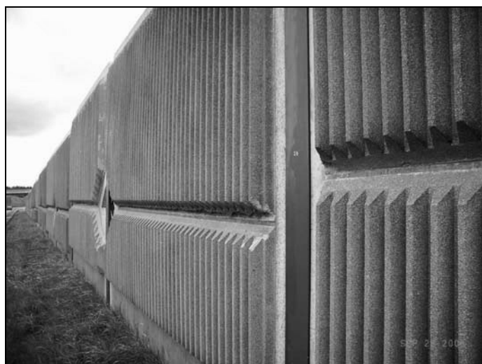
Bild 2: LSW mit Schäden an den Vorsatzschalen aus HPLB
